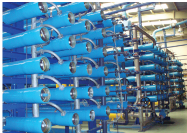
Hệ thống RO xử lý nước lợ/nước biển công suất lớn
